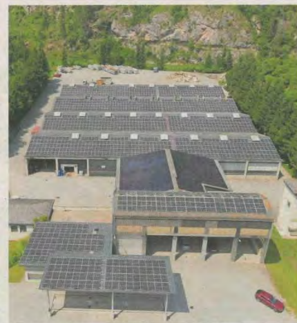
Die Photovoltaik-Anlage auf den Dächern des AWV Murau
